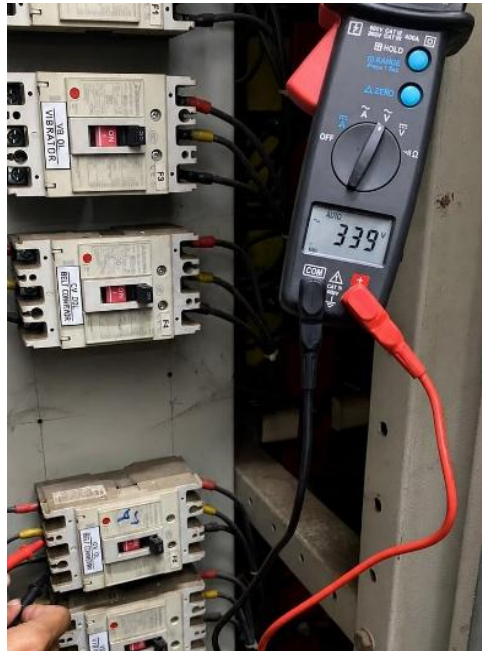
GAMBAR 7 Data Pengukuran Tegangan 339 V
