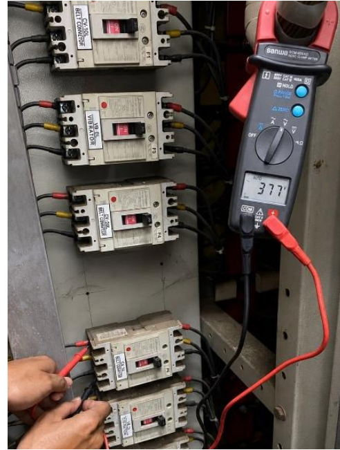
GAMBAR 8 Data pengukuran tegangan 377 V
